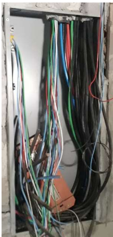
Figura 4 – Quadro de Distribuição – Local do CD01
