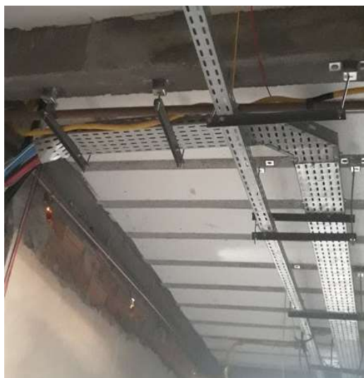
Figura 5 – Linha de Eletrocalhas existentes
